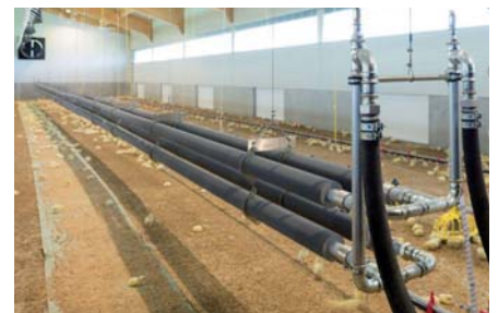
Les tuyaux de chauffage dans le poulailler
