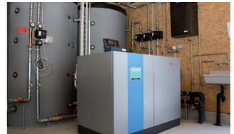
Le local technique avec la pompe à chaleur et les deux réservoirs d'eau chaude
