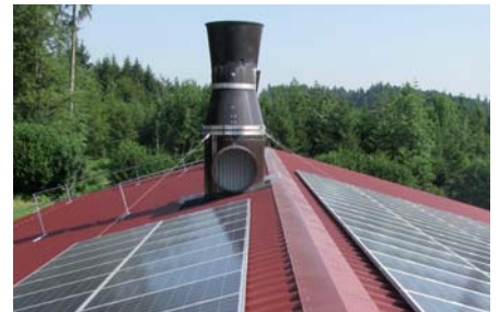
L'un des deux récupérateurs de chaleur (Reventa)
