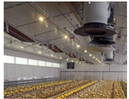
Die Wärmeverteilung erfolgt in Hellsau über frei hängende Rippenrohre. Im Vordergrund ersichtlich ist ein Zuluftverteiler.
