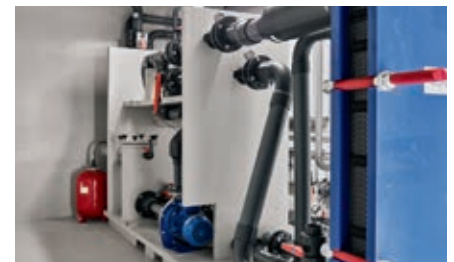
Plattenwärmetauscher, welcher dem Waschwasser die Wärme entzieht und diese an einen zweiten Kreislauf abgibt, welcher dann die Zuluft aufwärmt. Bild: Bell
